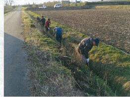
用排水路の点検&機能診断並びに泥上げ作業(開バイ1工区)
