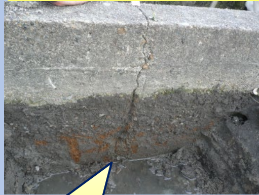
縦方向のひび割れ
