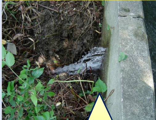
目地の開き (漏水)
