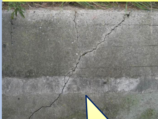
斜め方向の割れ
