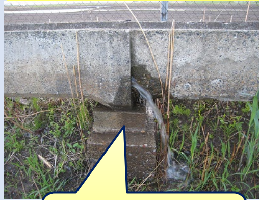
目地の開き (漏水)
