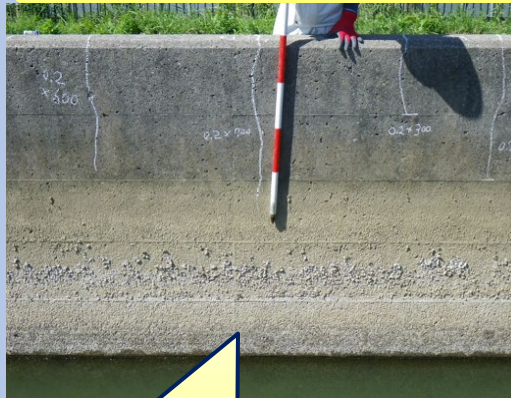
乾燥収縮等による ひび割れ
