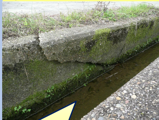
段差のあるひび割れ
