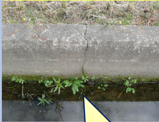
乾燥収縮等による ひび割れ
