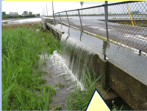
沈下による溢水
