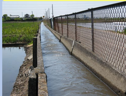
沈下による変形
