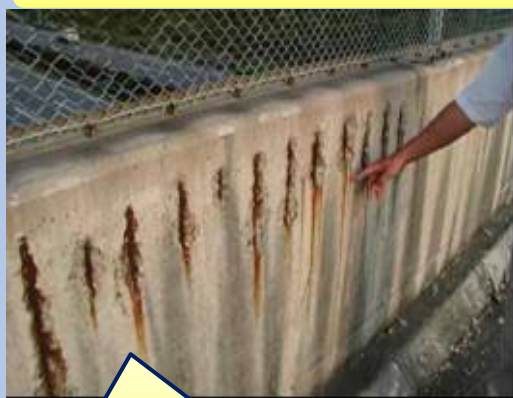
短い間隔のひび割れ
