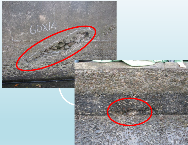
水路の壁にあいた穴
