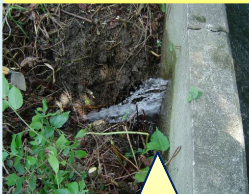
目地の開き (漏水)
