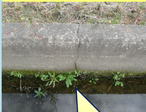
縦方向のひび割れ
