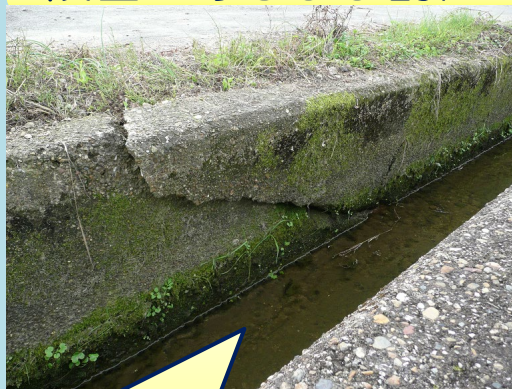
段差のあるひび割れ
