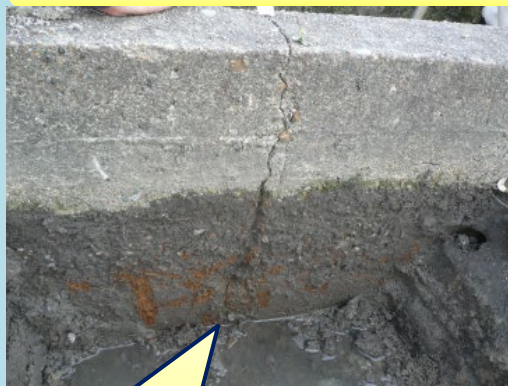
縦方向のひび割れ
