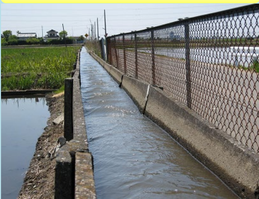
沈下による変形
