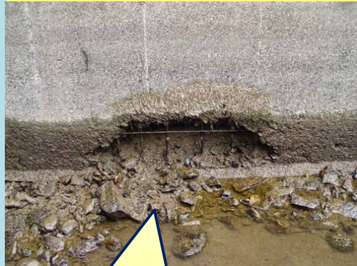
鉄筋が露出した欠損
