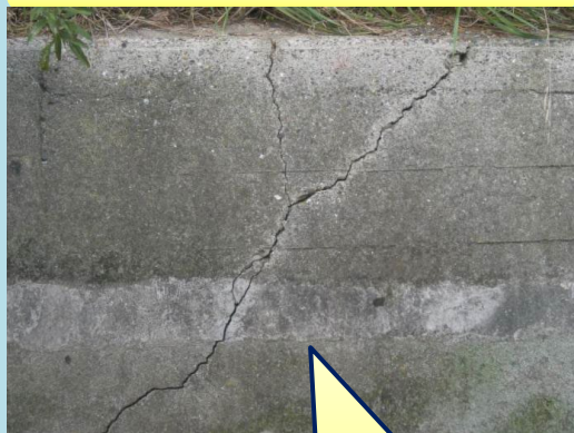
斜め方向に走る割れ
