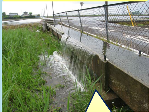
沈下による溢水
