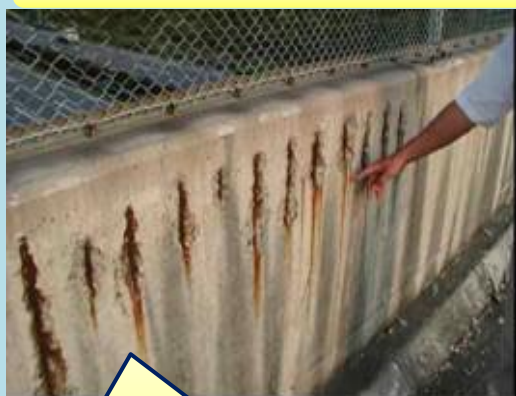
短い間隔のひび割れ
