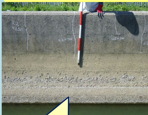
縦方向のひび割れ
