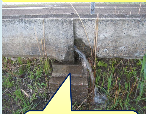
目地の開き (漏水)
