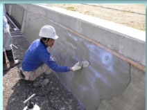
老朽化した水路壁の表面被覆
